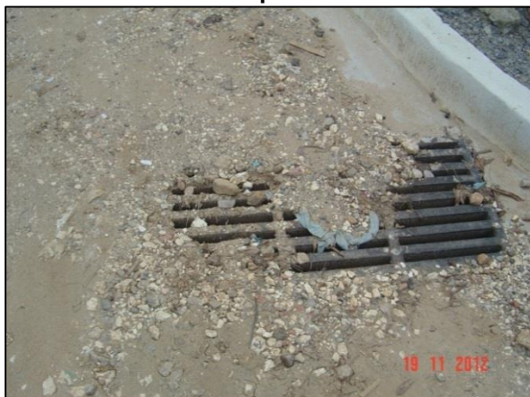
Figura 31 – Boca de lobo com problemas de limpeza
