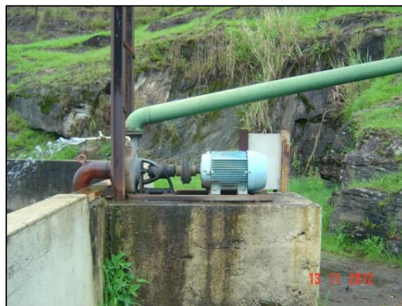
Figura 13 – Estação Elevatória de Água Bruta Nelson Carneiro
