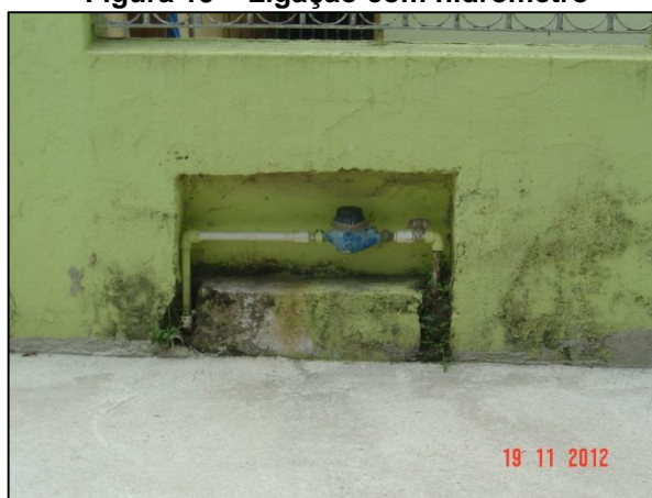
Figura 19 – Ligação com hidrômetro
